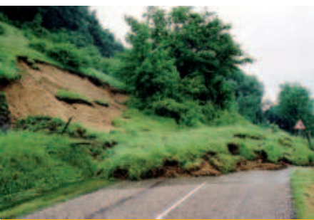
>>> Route bloquée par un glissement de terrain
